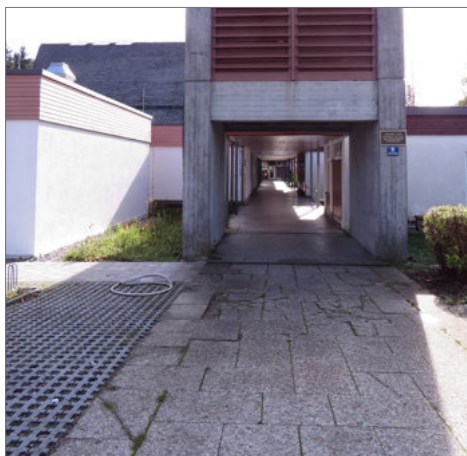
Wegen seines schlechten Zustands muss der Hauptzugang zum Pfarrzentrum erneuert werden
