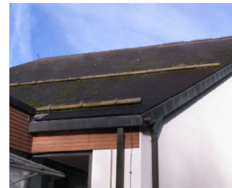
Kirchendach: Faserzementdachplatten und Schneefangbalken müssen erneuert werden
